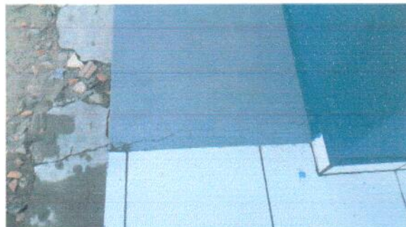
Foto 8 – Trincas nas calçadas
