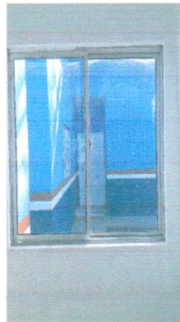
Foto 10 – Fecho da esquadria quebrado
