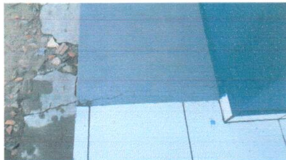
Foto 8 – Trincas nas calçadas
