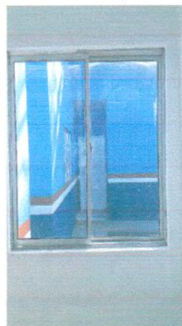
Foto 10 – Fecho da esquadria quebrado
